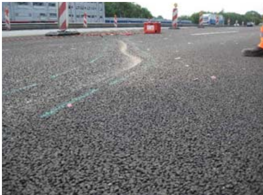
Skada i asfalt orsakad av en snöplog
