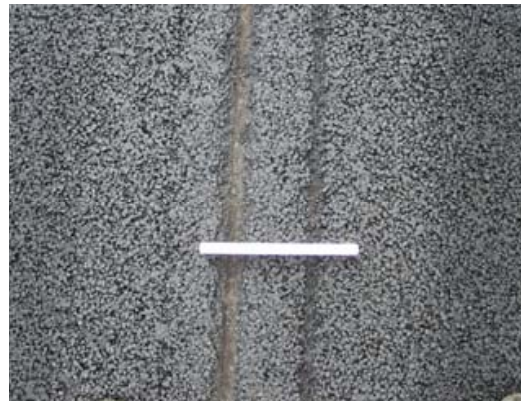
Skada i asfalt orsakad av en lastbil
