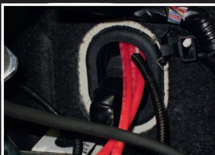
Genom torpedväggen till manöverpanelen.
